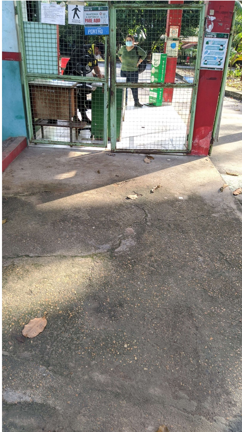
Ausência de rampas nas entradas
