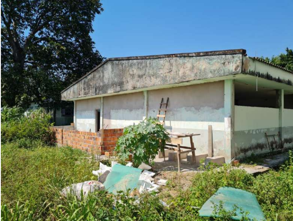
Figura 06: Panorâmica do fundo da edificação - esquadrias retiradas, fechamento em alvenaria, chapisco e reboco
