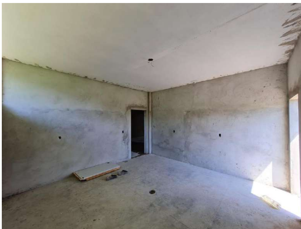
Figura 18: Laboratório de tecnologia de secagem de pescado - retirada de azulejos, retirada de esquadria, fechamento em alvenaria, revestimento em chapisco e reboco, arremate em vãos de janelas e portas.
