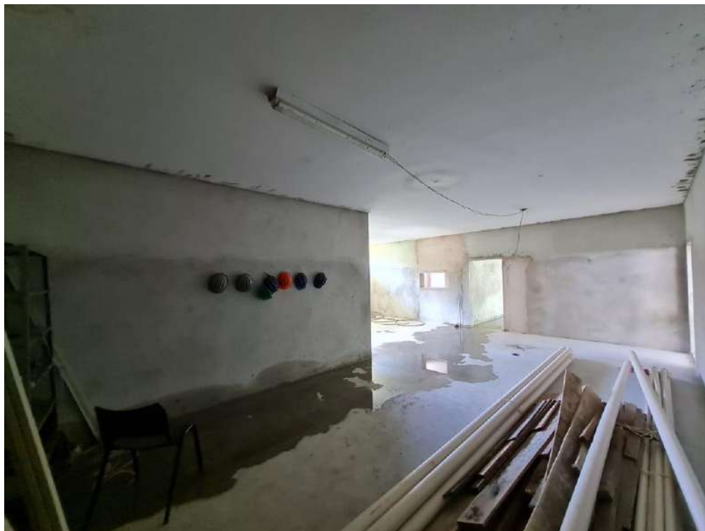
Figura 16: Laboratório de tecnologia de alimentos – retirada de azulejos, retirada de esquadria, fechamento em alvenaria, revestimento em chapisco e reboco, arremate em vãos de janelas e portas.
