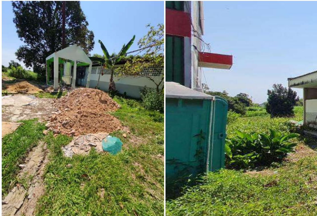
Figuras 29 e 30: Volume de material solto para reaterro e descarte do excedente; banheiro químico a ser retirado para inclusão de novo conforme planilha
