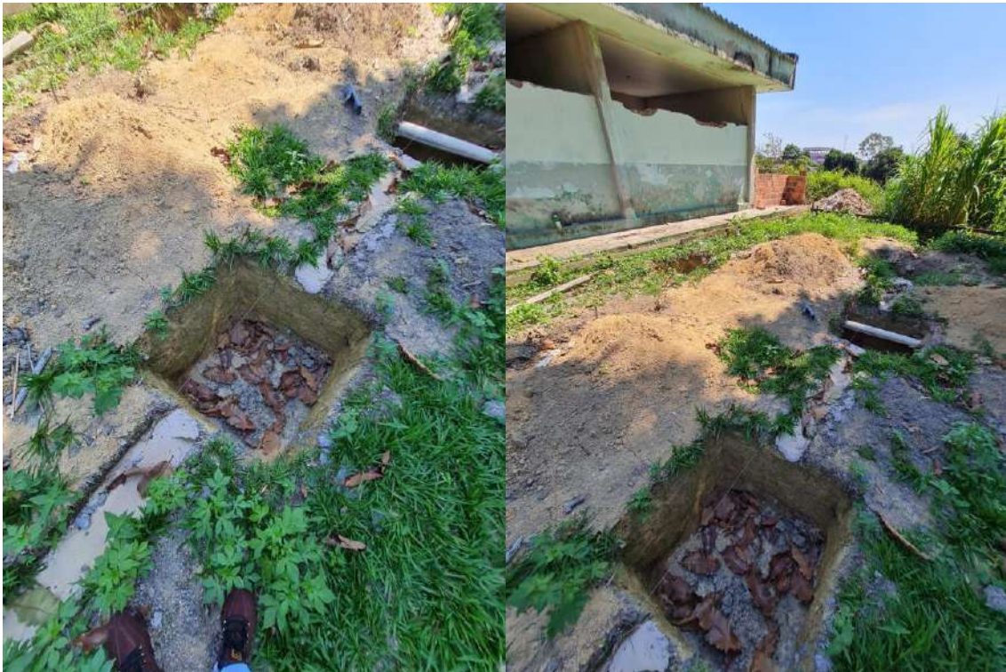
Figuras 24 e 25: Infraestrutura do vestiário – escavação sem sapata (04 unidades); Obs: tubulação de água e de esgoto atravessando uma linha de 3 (três) sapatas.
