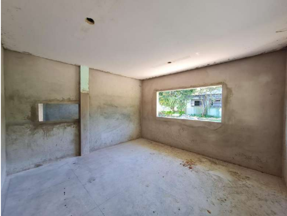
Figura 13: Sala das técnicas de alimentos – revestimento em chapisco e reboco executado, verga e contraverga, vão de janela, arremate em pilar
