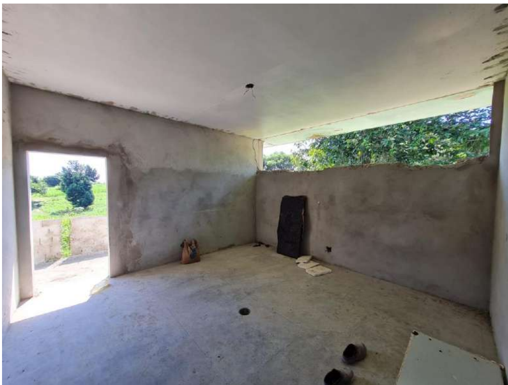
Figura 17: Laboratório de tecnologia de secagem de pescado - retirada de azulejos, retirada de esquadria, fechamento em alvenaria, revestimento em chapisco e reboco, arremate em vãos de janelas e portas.
