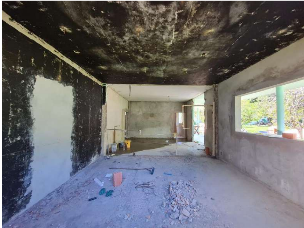
Figura 12: Laboratório de bromatologia – aplicação parcial de chapisco e de reboco
